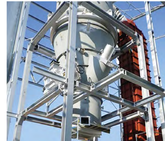
Thermische Verwertung von Klärschlamm, Stadtwerke Mainz (DEU)
